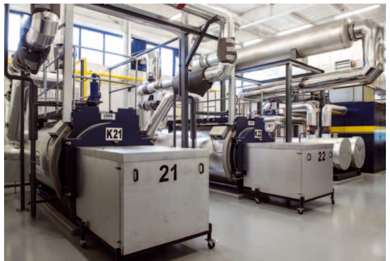
Celkové pohledy na technologii kotelny
