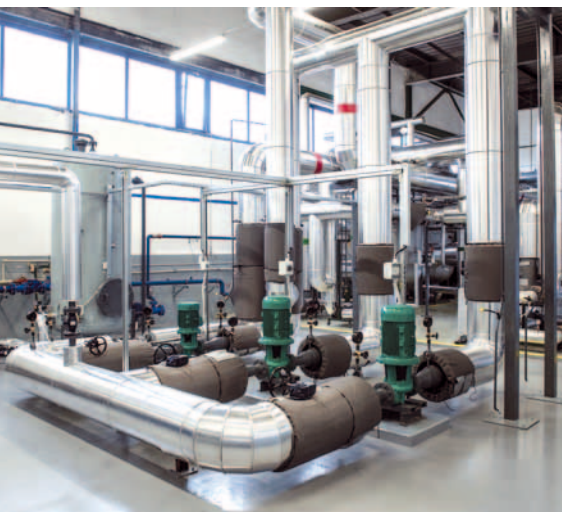
Celkové pohledy na technologii kotleny
