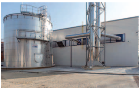
Celkové pohledy na technologii kotleny
