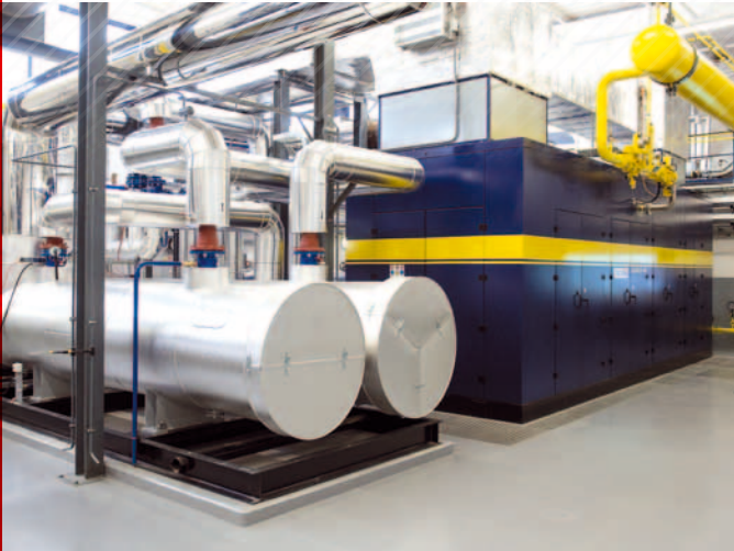
Celkové pohledy na technologii kotelny
