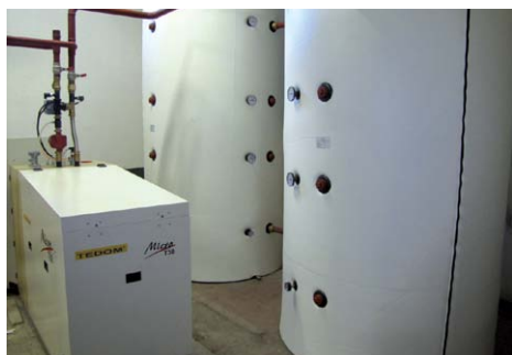
Starou kotelnu ve škole a původní kotel (nahore) doplnily mikrokogenerace a akumulční nádrže pro vyrobenou teplou vodu (dole).
