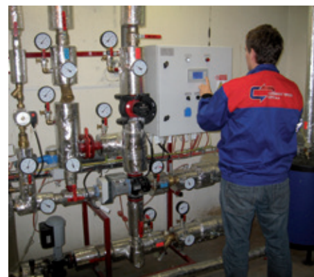
Předávací stanice v domě č. p. 747 Jasenka
