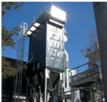
Filtrační zařízení kotelny K3 Kylešovice
