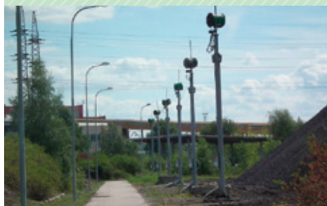
Mlžící stěna na překladništi Vršanské uhelné je tvořena šesti mlžícími jednotkami.
