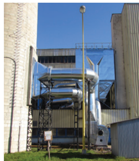
Nově instalovaná filtrační jednotka na kotelně 35 v Jasenicích
